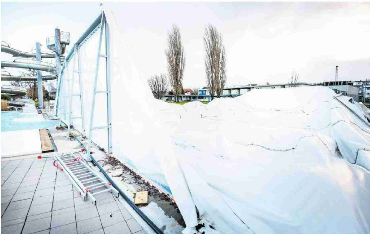
Die orkanartigen Winde beschädigten die Traglufthalle Winterwasser Oberthurgau in Romanshorn.
